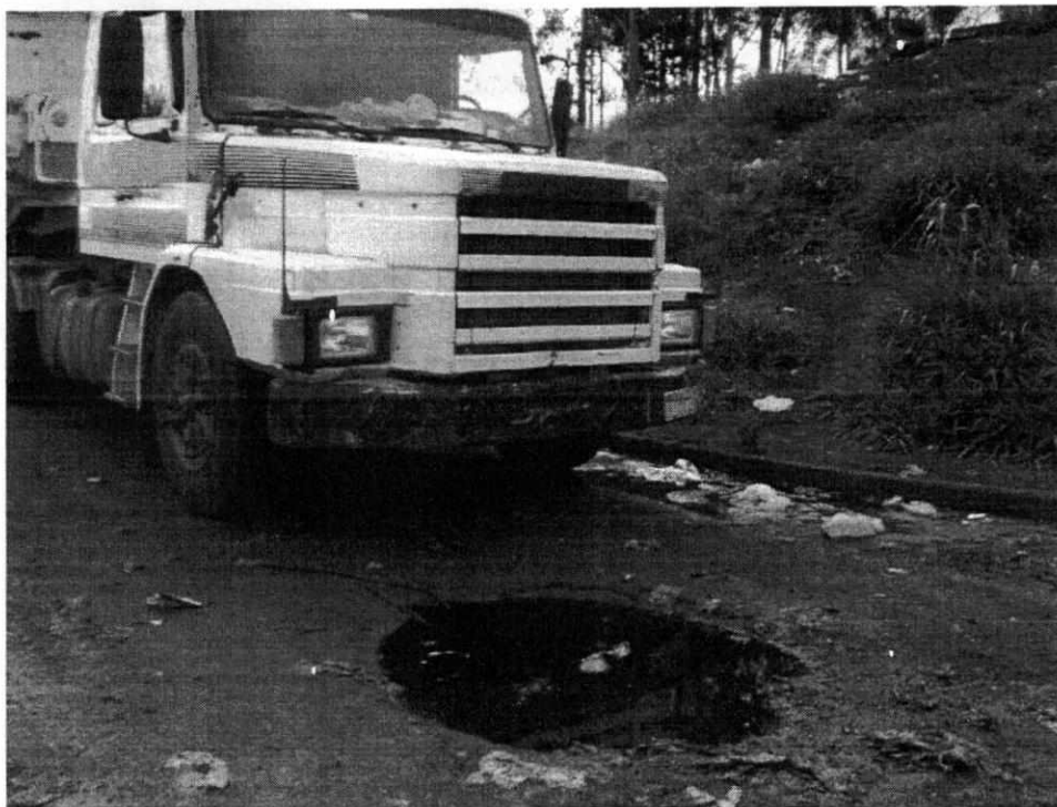
Figura 4 - Buracos na estrutura asfáltica
