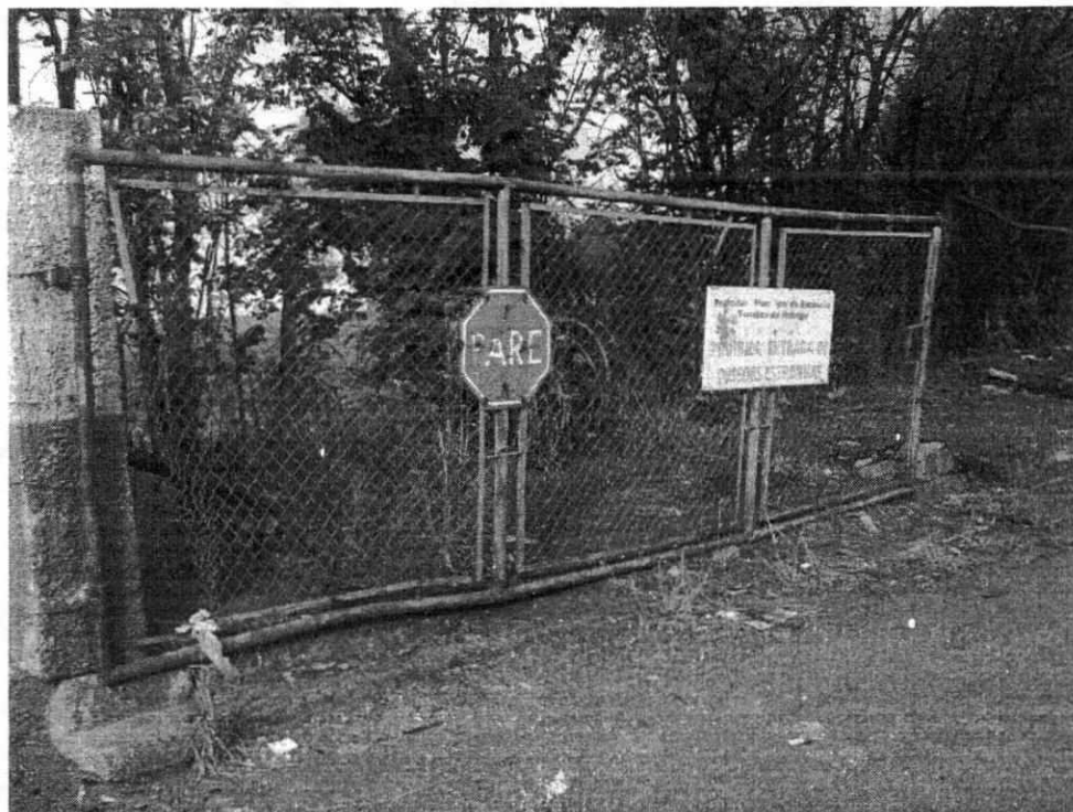
Figura 14 - Estrutura danificada do portão de entrada
