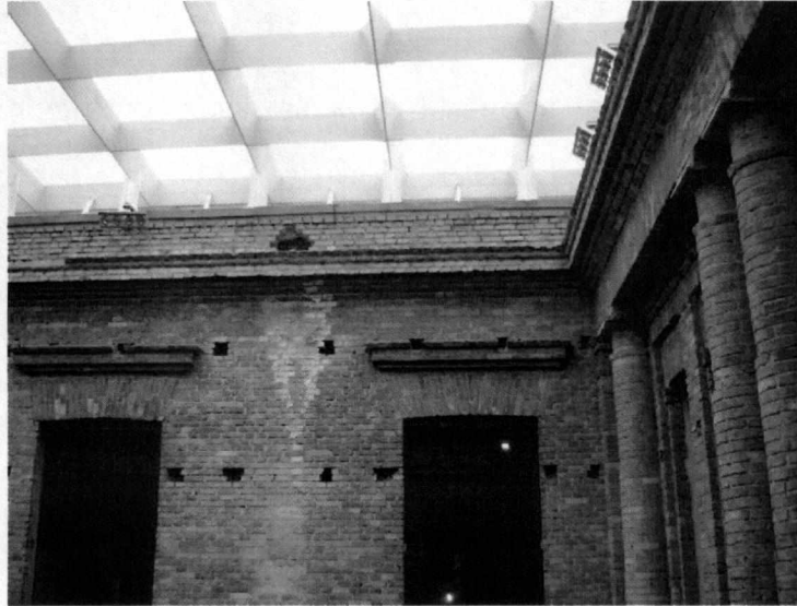
Local de captação por onde seguirão dutos sobre os forros do pavimento abaixo da cobertura.
